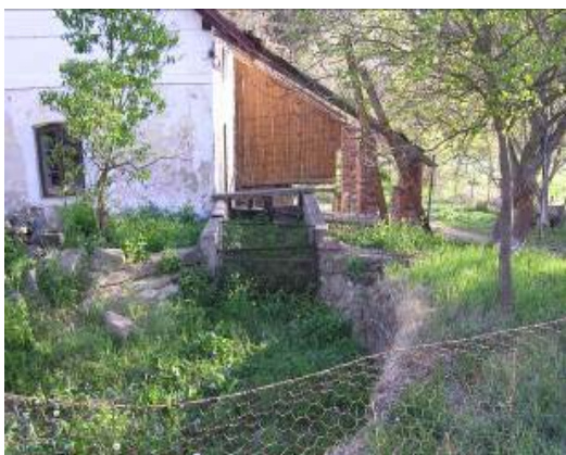
Obrázek č. 11 – Pohled na vantroky před rekonstrukcí
