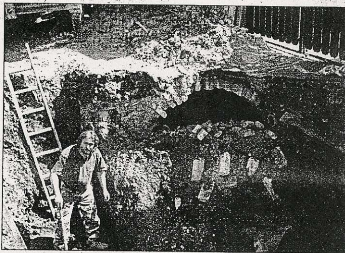
Místo, kde se na Březových Horách propadly struhy. Nad nimi by měla vést trať hornického vláčku. Foto Anežka Hučková
