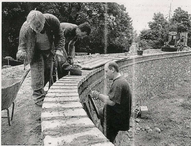
BUDOUCÍ KOLEJÍŠTĚ. Dělníci budují na nádvoří Ševčinského dolu v areálu Hornického muzea Příbram první úsek dráhy hornického vláčku. FOTO: FRANTIŠEK J. KUBÍK
