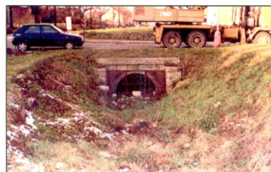
Kanalizační vpust' na Chelčické ulici - Pomocný hlásný kategorie "C"
