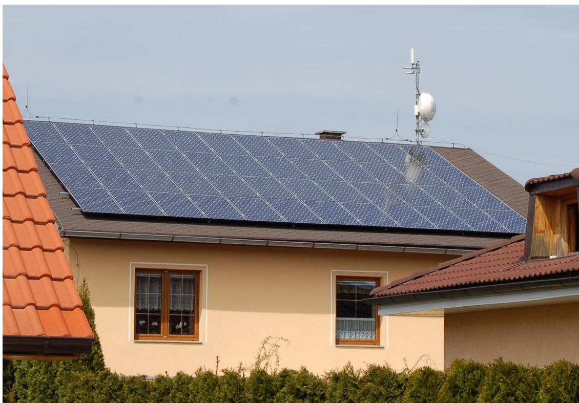
Zdroj: vlastní foto – FVE na rodinném domu manželů Novotných, Dasný
