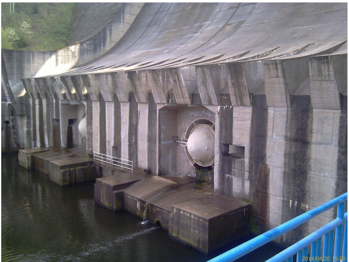
Obr. č. 2: Pohled na Johnsonovy uzávěry (výpustě) z místa vodní elektrárny.
