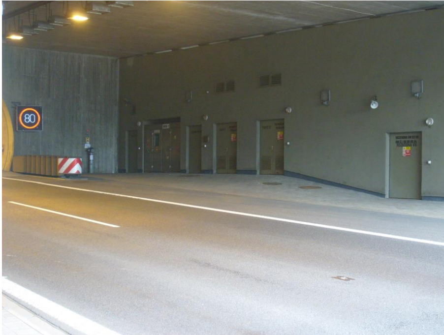
Provozní velín operátora dopravy a operátora technologie tunel Panenská – Jih.
