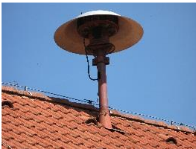
Obr. 6: Elektrická rotační siréna. 42
