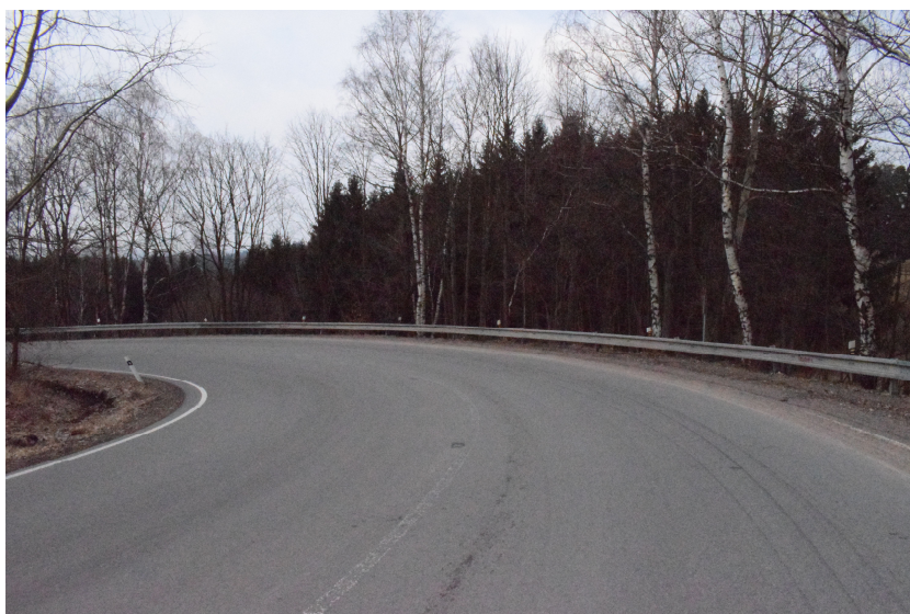
Obr. 11: Nečitelné vodorovné dopravní značení se znečištěnou zpevněnou krajnicí v katastru obce Jablonné nad Orlicí na silnici I. třídy č. 11. 109
