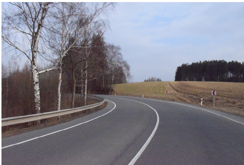
Obr. 10: Dobře čitelné vodorovné dopravní značení s čistými zpevněnými krajnicemi v katastru obce Šedivec na silnici I. třídy č. 11. 108
