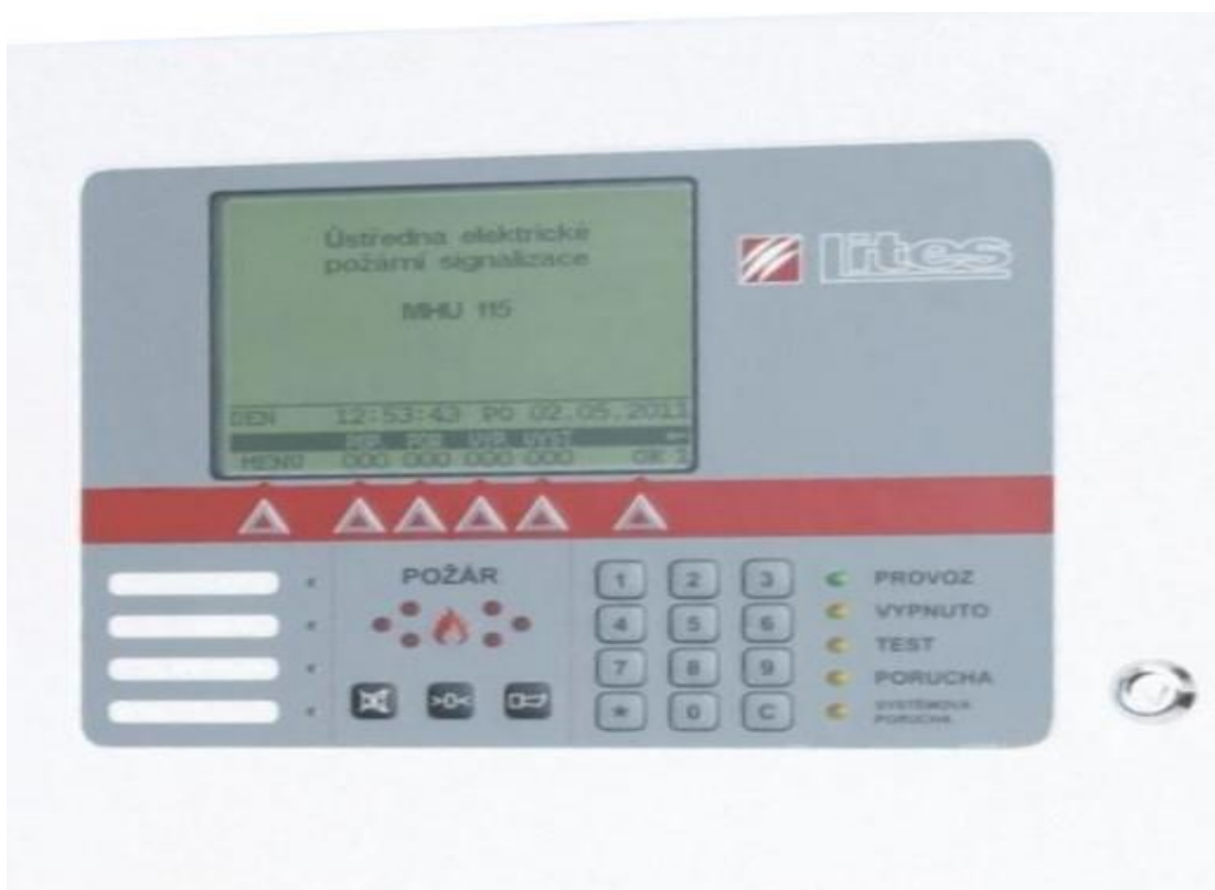
Obr. 3 Ústředna elektrické požární signalizace 12
