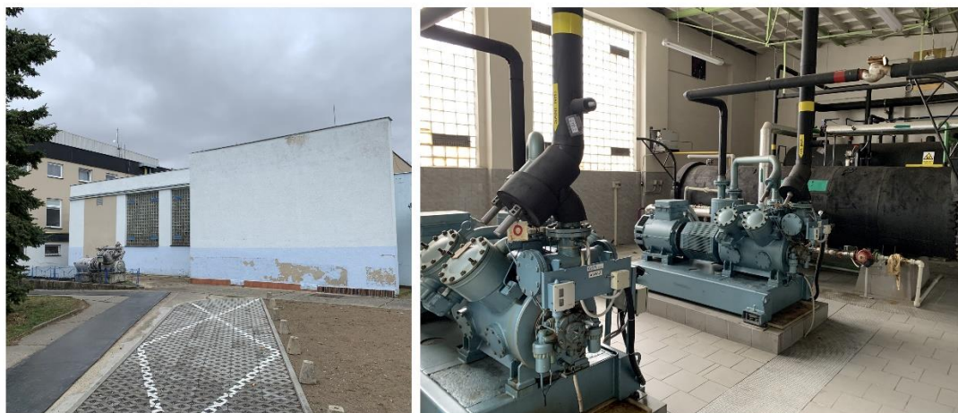
Obrázek č. 2 – budova strojovny a pohled do strojovny Zimního stadionu Příbram 26
