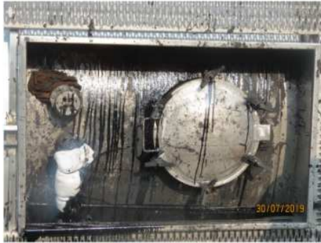
13. místo úniku asfaltu z cisterny
