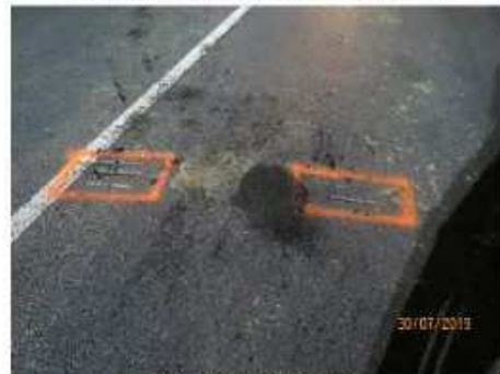
10. stopy na vozovce
