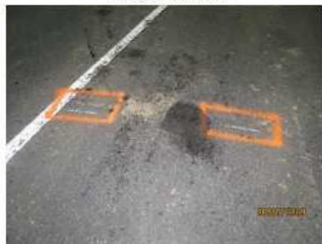
11. stopy na vozovce
