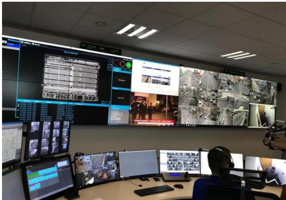
Obrázek 4: Dohledové, přijímací a poplachové centrum 23
