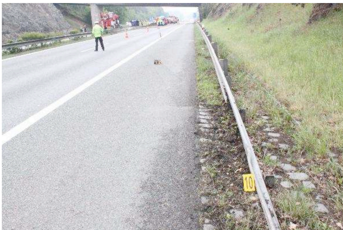
Obrázek 16 Pohled na poškozená ocelová svodidla a smykovou stopu, zdroj: vlastní
