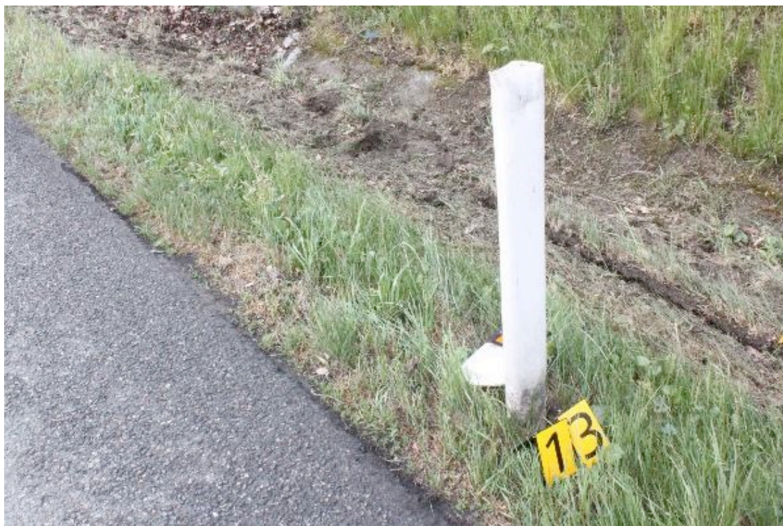
Obrázek 15 Pohled na poškozený směrový sloupek, zdroj: vlastní
