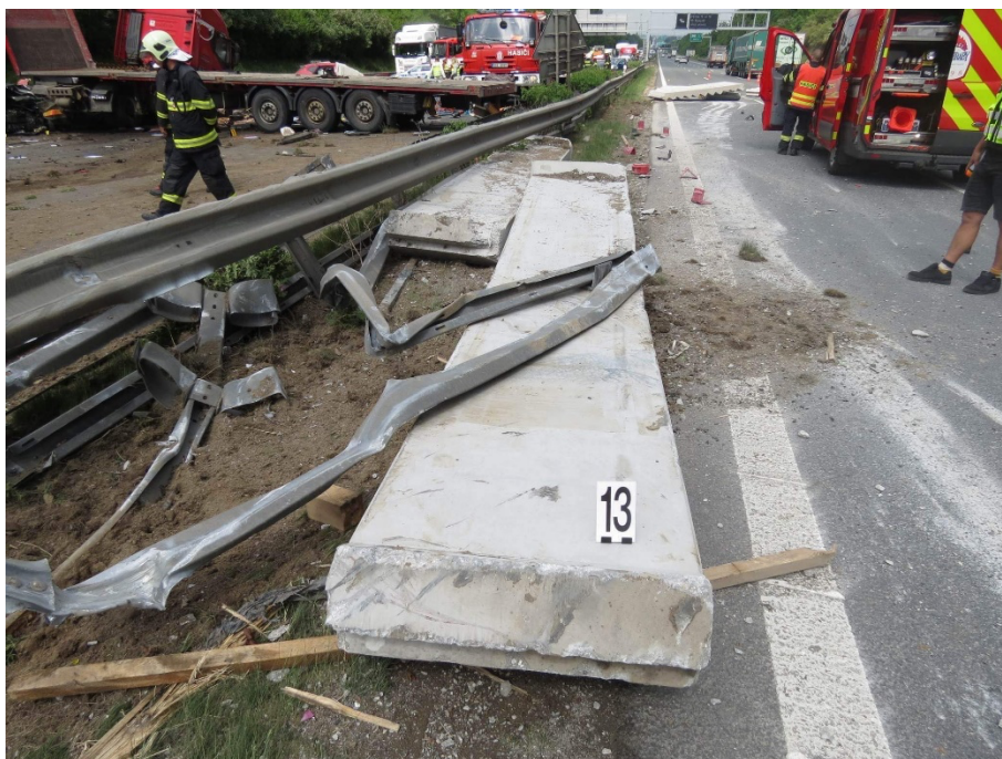
11 Pohled na poškozená svodidla a betonové panely, zdroj: vlastní
