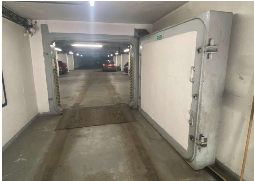
Obrázek 5 Tlakové dveře ve více účelovém úkrytu (zdroj vlastní)
