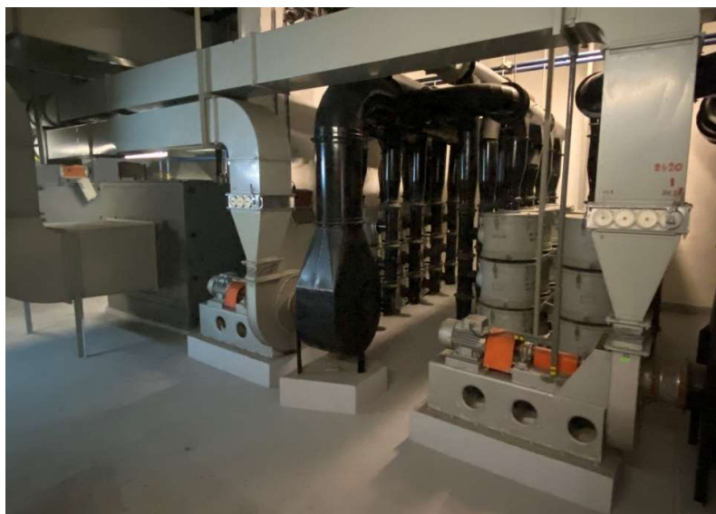
Obrázek 6 Filtrventilační zařízení (zdroj vlastní)
