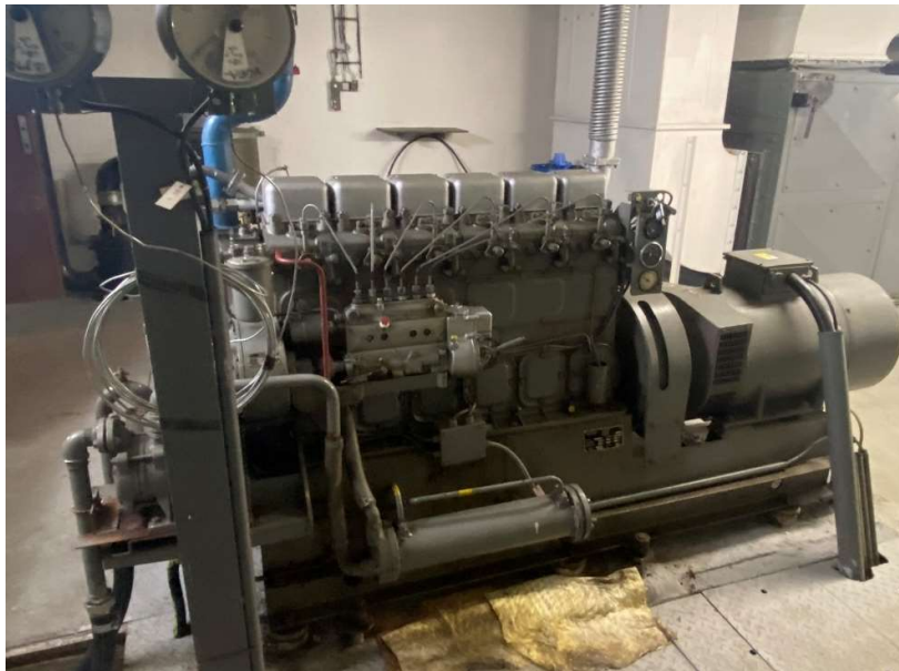
Obrázek 7 Elektrické zdrojové soustrojí (zdroj vlastní)
