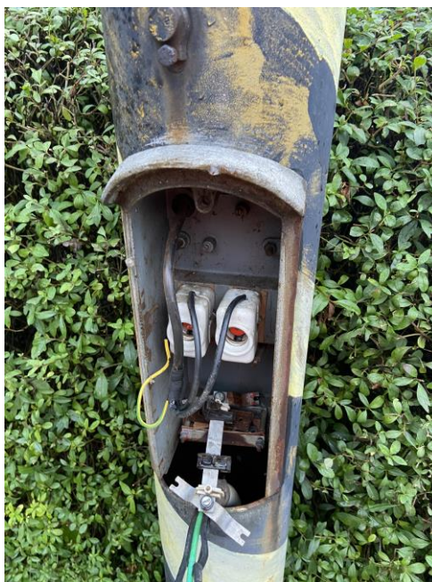
Obr. 2: Odcizený oddělovací bezpečnostní transformátor z osvětlovacího stožáru v ŽST Zliv (trať č. 190) 112
