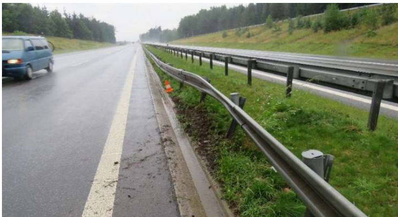
Obr. 12 Poškozené svodidlo na dálnici 46
