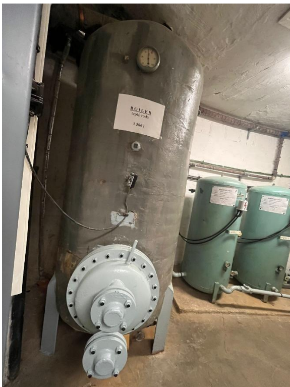
Pohled na vodní hospodářství – vodní zásobník, bojler na ohřev vody.
