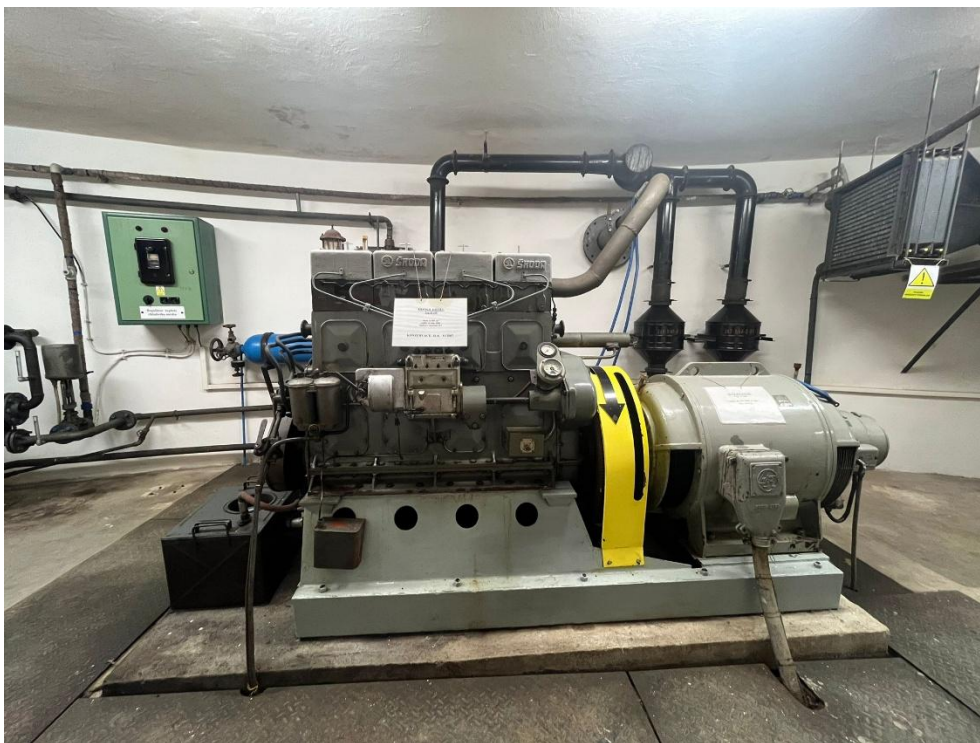
Pohled do strojovny elektrické energie – diesel agregát.
