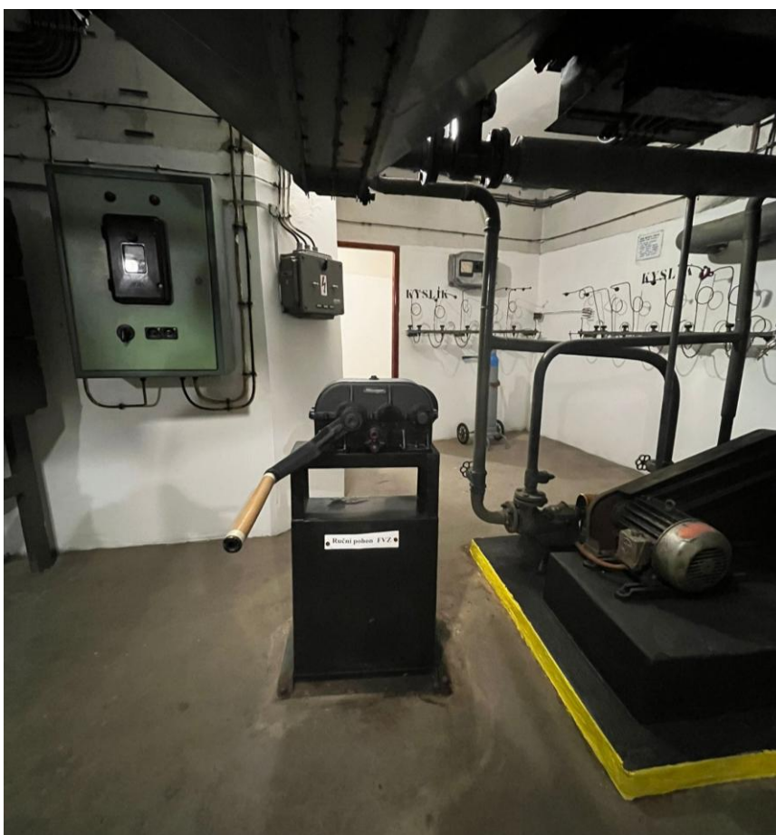
Pohled do strojovny filtroventilace na ruční pohon.
