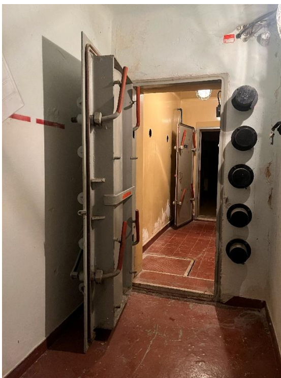
Pohled na protitlakové dveře s těžkými plynotěsnými uzávěry.
