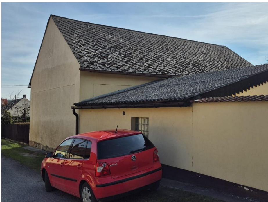
Obrázek 4 - Biologické znečištění střechy, zdroj: Vlastní
