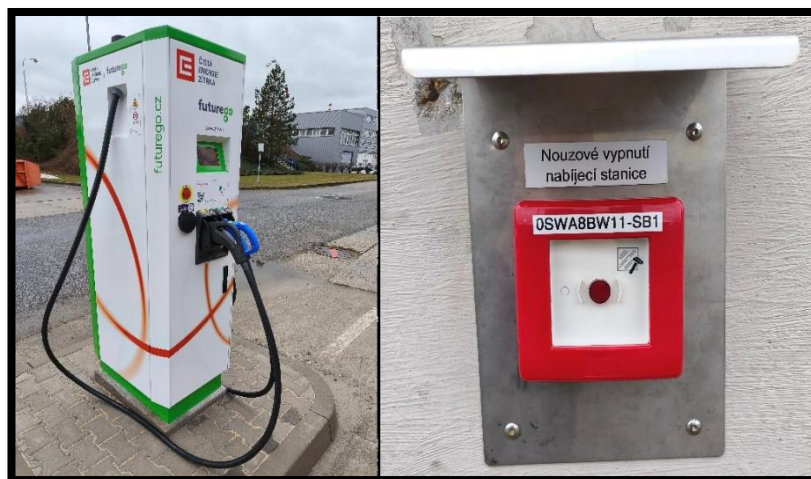
Obrázek 12. DC dobíjecí stanice ve STP JE Temelín/ nouzové odpojení stanice. Zdroj: Vlastní zpracování
