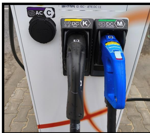
Obrázek 9. Konektory CCS a CHAdeMO na DC dobíjecí stanici. Zdroj: Vlastní zpracování
