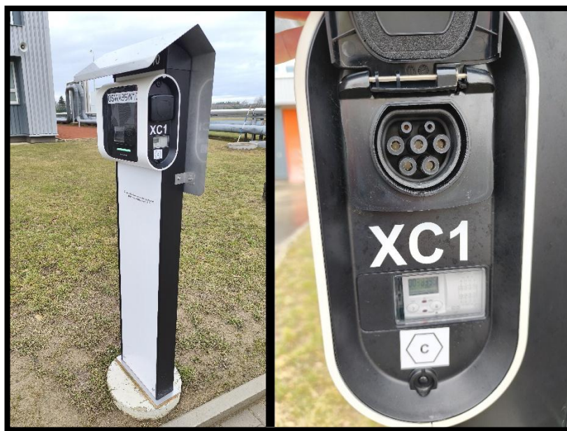
Obrázek 11. Wallbox ve STP JE Temelín. Zdroj: Vlastní zpracování
